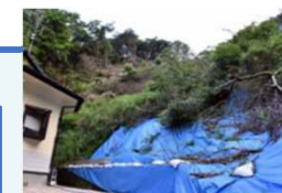
豪雨の度に 土砂崩れが多発
