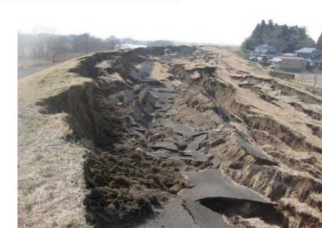
河川堤防の損傷
