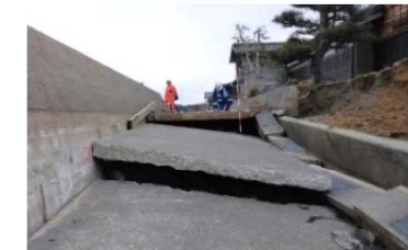
護岸・水叩きの損傷
