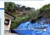
豪雨の度に 土砂崩れが多発
