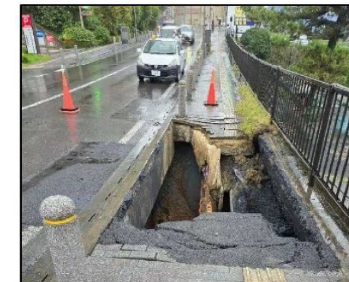
令和6年10月9日に茨城県水戸市で発生した道路陥没事故
