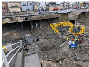
令和7年1月28日に埼玉県八潮市で発生した道路陥没事故
