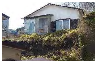
コンクリート擁壁が手入れされていない土地
