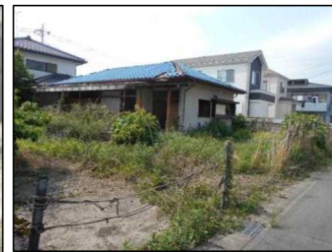
適切に管理されていない空家等 (雑草が繁茂、屋根の一部が欠損)
