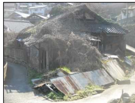
特定空家等 (老朽化が進み、倒壊等の危険性大)
