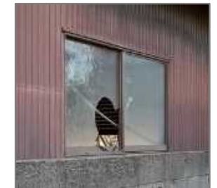
窓が割れた管理不全空家
