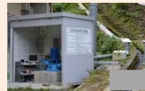
小水力発電設備
