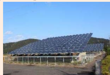
太陽光発電設備
