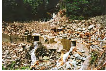
大川村鈴ヶ谷 県道の被災 (平成16年)
