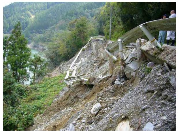
大川村小南川県道の被災(平成17年)
