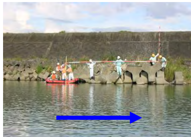
台風14号 吉原箇所 水制崩落状況
