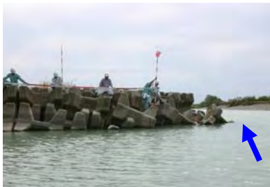
台風14号 吉原箇所 水制崩落状況
