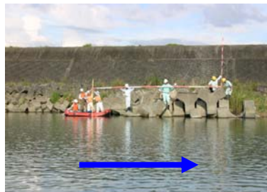
台風14号 吉原箇所 水制崩落状況
