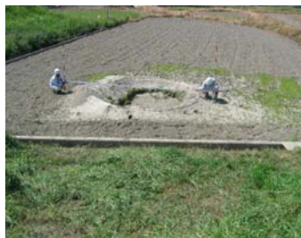
平成17年洪水 土佐市用石地区漏水
