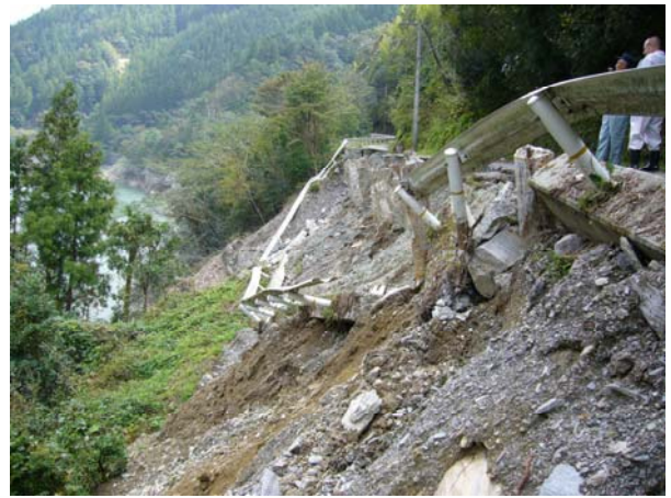
大川村小南川県道の被災(平成17年)
