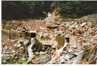
大川村鈴ヶ谷 県道の被災 (平成16年)
