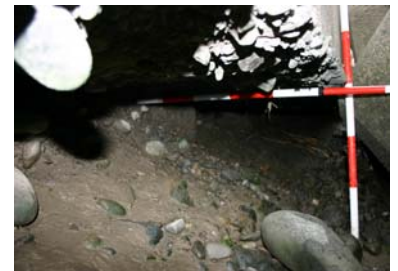
台風14号 吉原箇所 洗掘状況
