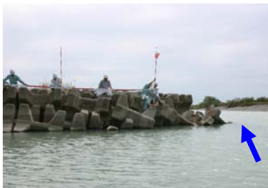
台風14号 吉原箇所 水制崩落状況
