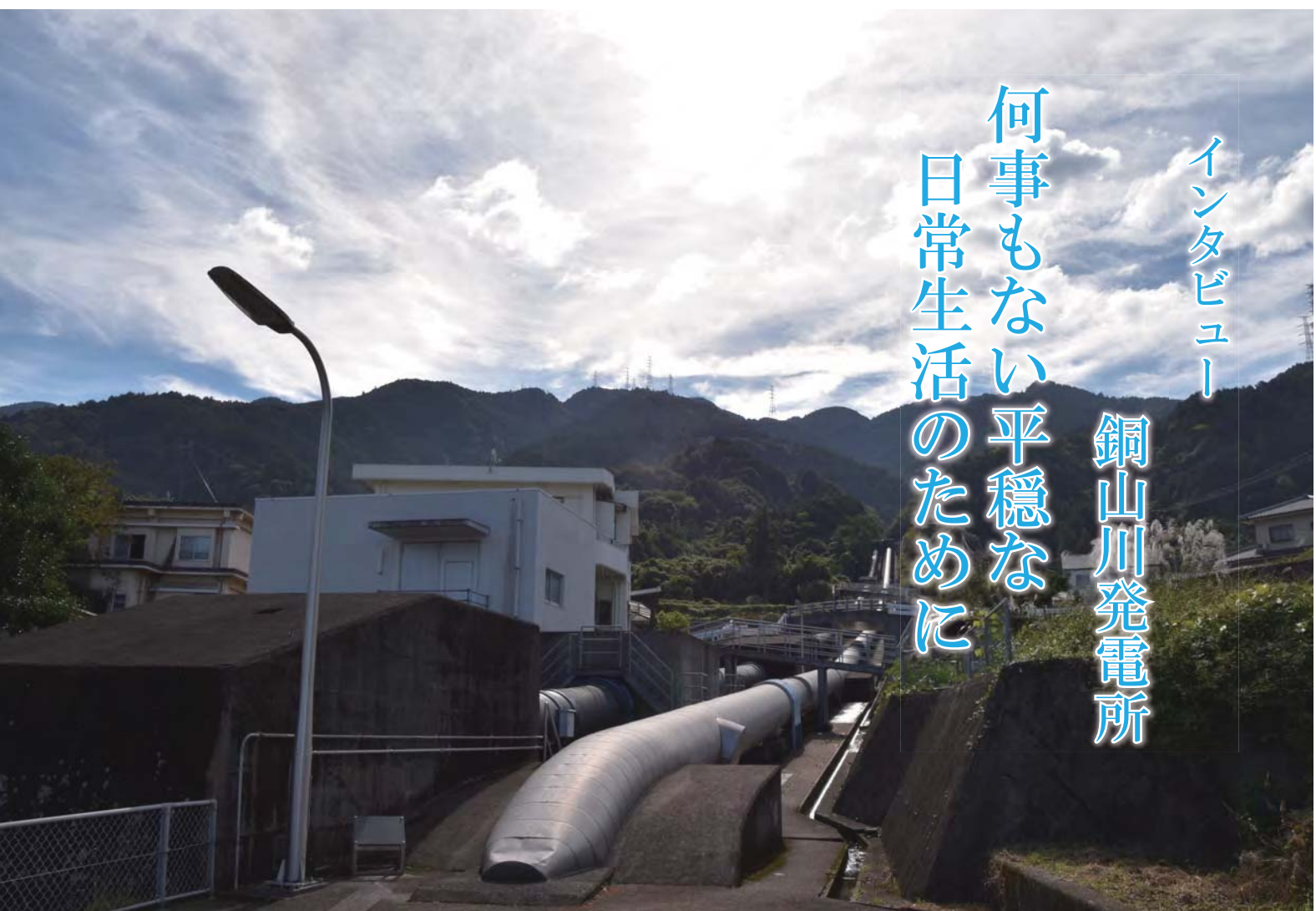
銅山川第一発電所の水圧鉄管。写真奥の法皇山脈を抜けて銅山川の水を四国中央市に導水している。
