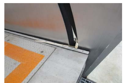
写真-4 異物の噛み込み状況
