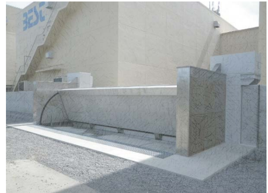
写真-1 フラップゲート式陸閘（閉塞状態）
