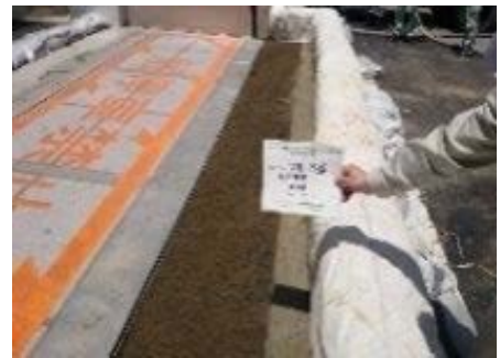
写真-5 導水溝完全閉塞状態
