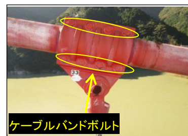
写真-3 ケーブルバンド状況
