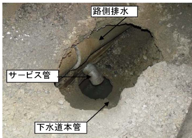
写真-1 埋設管破損が原因の空洞
