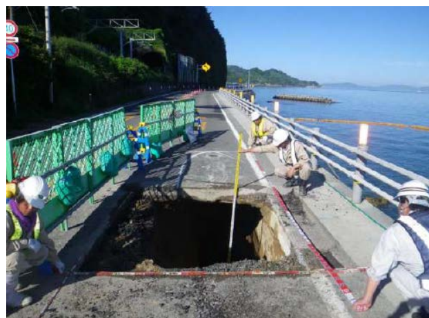
写真-2 海岸護岸の吸出しによる空洞
