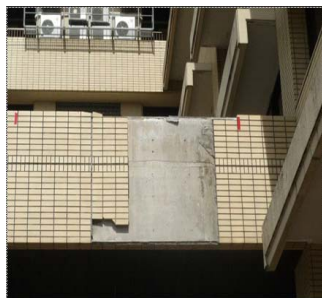
■タイルが落下した非常に危険な状況
