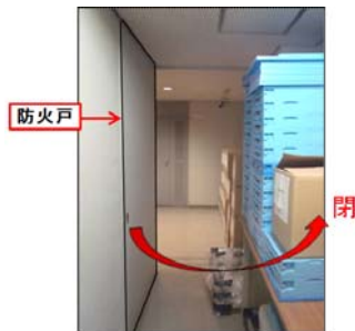
■避難上重要な扉が閉まらない状況
