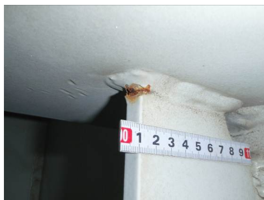
写真-7 疲労亀裂発生箇所
