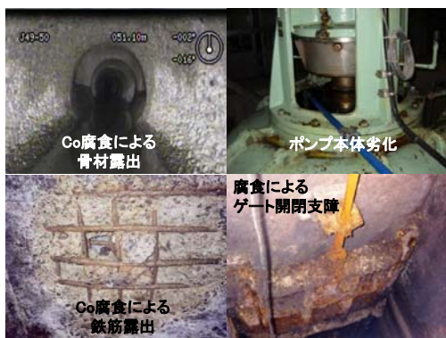
写真－3 管路、処理場の老朽化事例
