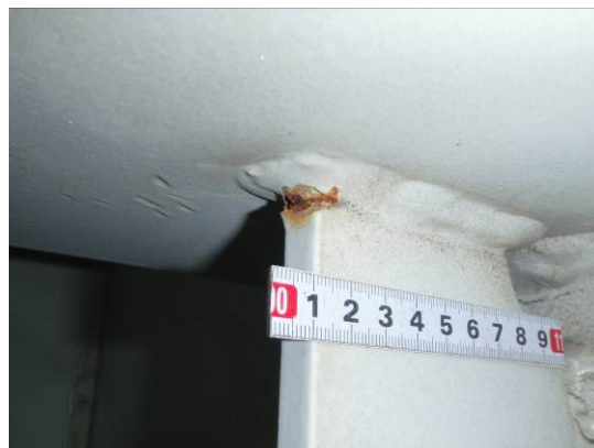
写真-7 疲労亀裂発生箇所
