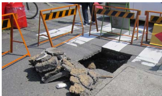
写真－4 管路の老朽化等に起因した道路陥没
