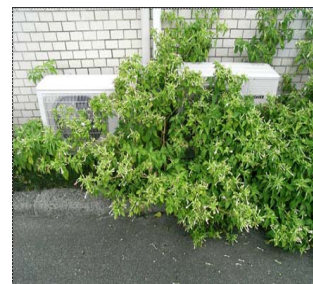
■室外機の運転機能低下
