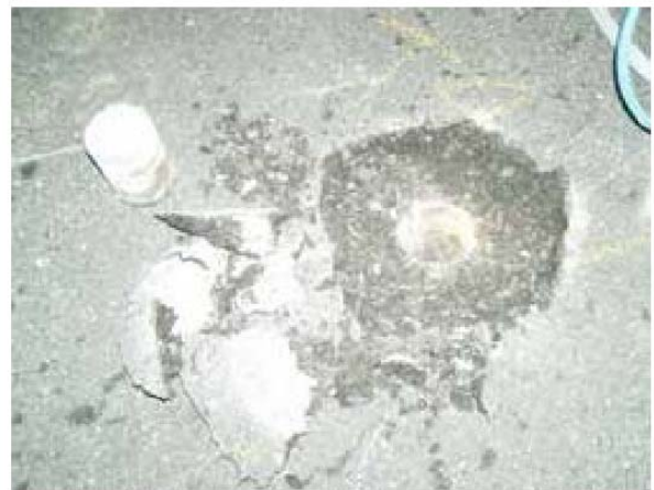
写真－4 コア採取（劣化が著しい事例）
