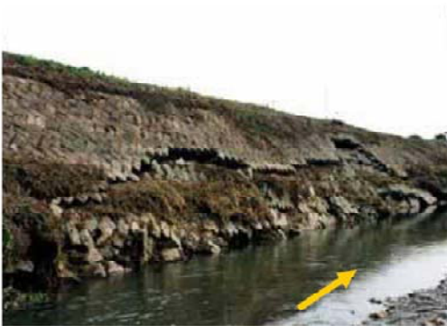
写真－3 護岸崩壊状況 (H9) 古川
