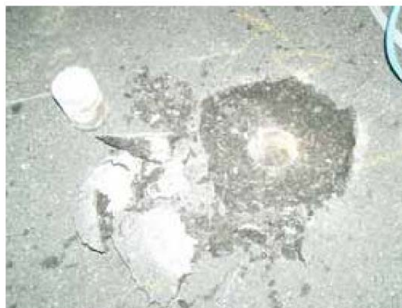
写真－4 コア採取（劣化が著しい事例）
