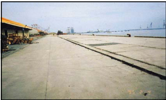
写真－2 無傷だったが落橋で使えなかった岸壁
