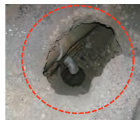
路面下空洞調査で発見した空洞
