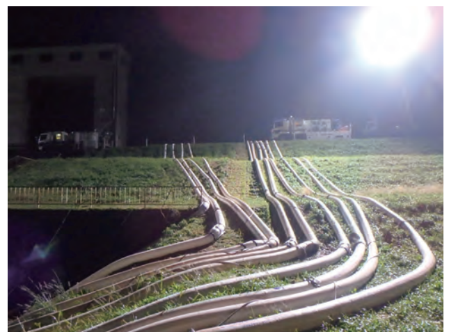
令和元年 10 月 台風 19 号により被災した関東地方整備局管内での排水作業支援
