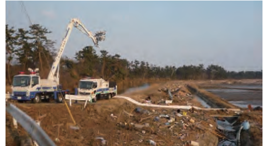
平成23年 東北地方太平洋沖地震での 照明車による排水作業支援状況
