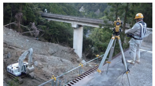
平成30年7月豪雨での遠隔操縦バックホウによる 崩落土砂撤去状況(高知県長岡郡大豊町)
