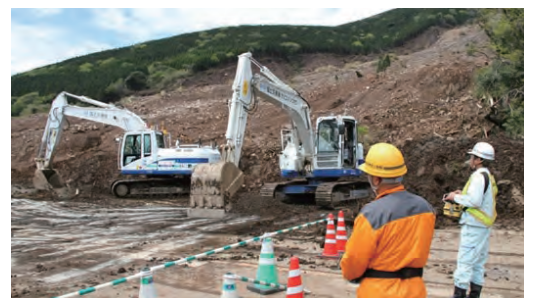
平成28年4月 熊本地震での遠隔操縦 バックホウによる崩落土砂撤去状況
