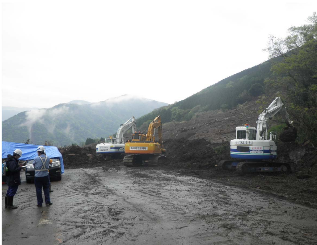
南阿蘇での掘削作業状況（複数のラジコンバックホウを投入）
