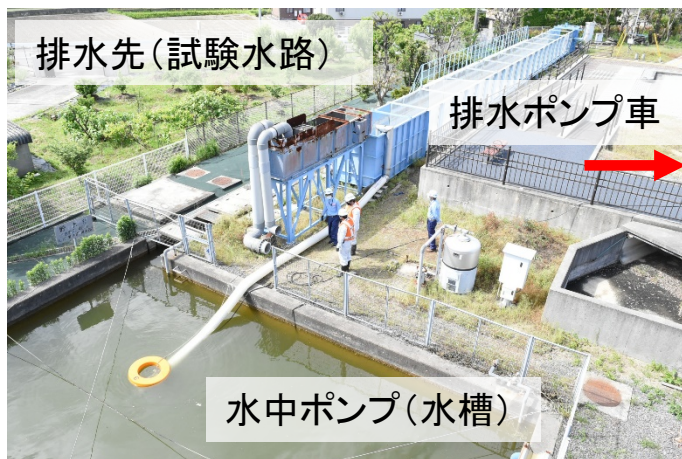
ポンプ運転状況
