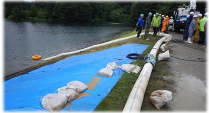
排水運転状況
