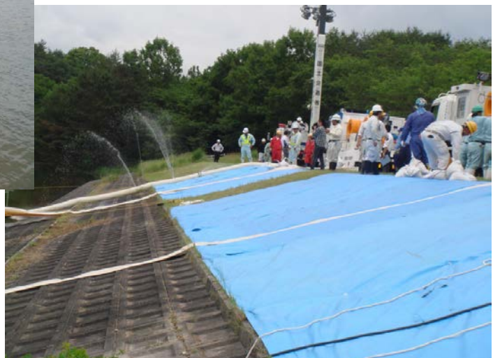
写真-6 排水ホースの不具合を確認
