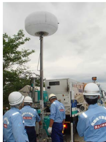
写真-8 バルーン照明
