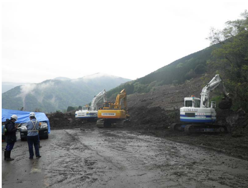
南阿蘇での掘削作業状況（複数のラジコンバックホウを投入）
