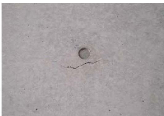
写真 7.1 沈みひび割れの事例（セパレータ部）
