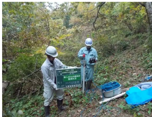
地すべり観測(孔内傾斜計観測状況)
