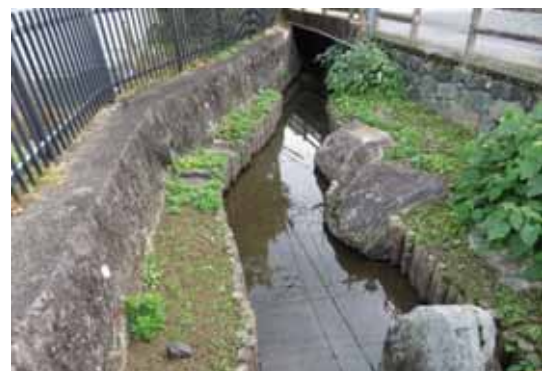
大洲南中学校前の水路（R4.12.8撮影）
