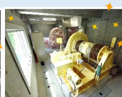
ゲート閉装置 (ゲート操作室内)
