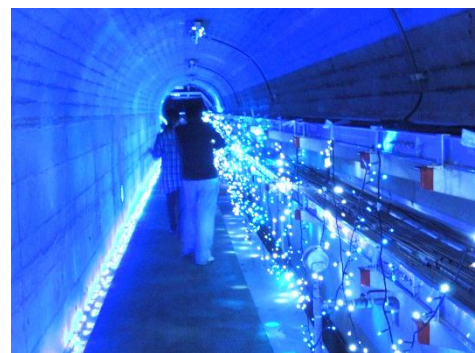
ダム内部イルミネーション装飾
