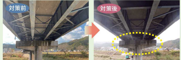
国道33号 富士見橋における水平力分担構造
