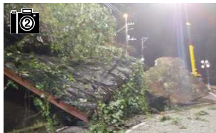
平成22年度に発生した岩盤崩落
