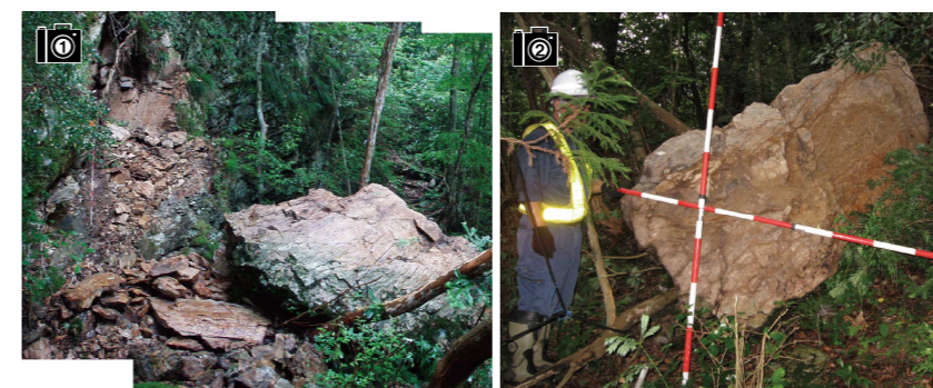
亀裂が発達し剥離した岩塊
