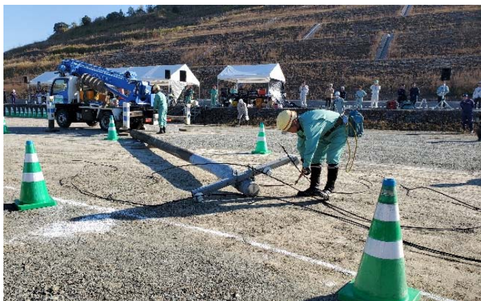
四国電力による停電確認を行った後、電線及び電柱の撤去を実施。
