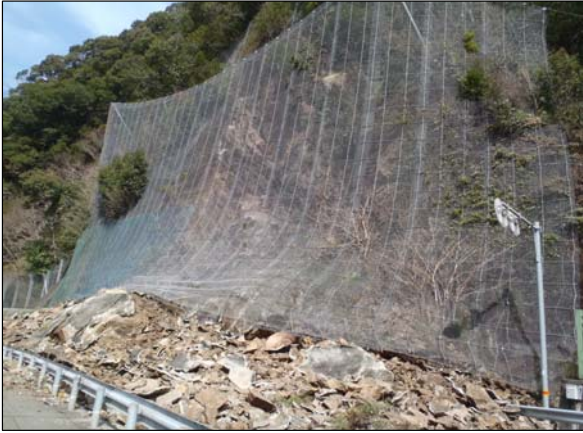
崩壊法面写真
