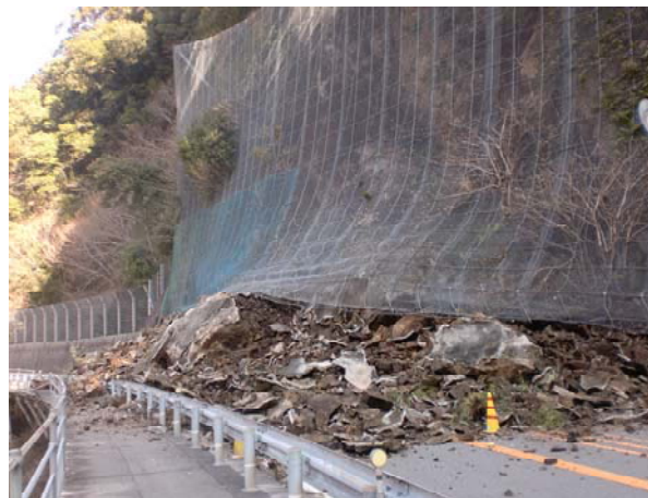
【崩壊後】 26日 10時頃
