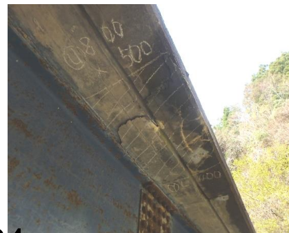
剥離・鉄筋露出
