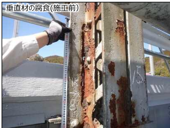
腐食部拡大(施工前 断面欠損)
