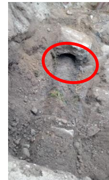
横断水路継ぎ目部に隙間が発生
