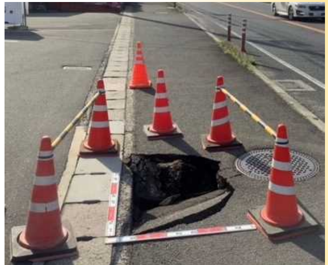
地下埋設物に起因する歩道の陥没
