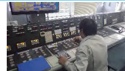
ダム放流操作
