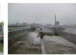
(排水分水ゲート)
