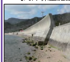
津波、高潮による被害を未然に防ぐため海岸堤防の整備を推進
