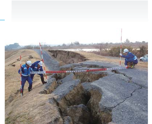
東日本大震災による被災状況 (出典:東北地方整備局)
