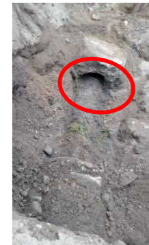
横断水路継ぎ目部に隙間が発生
