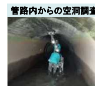
管路内からの空洞調査 管路内から管路背面の地盤の空洞を調査
