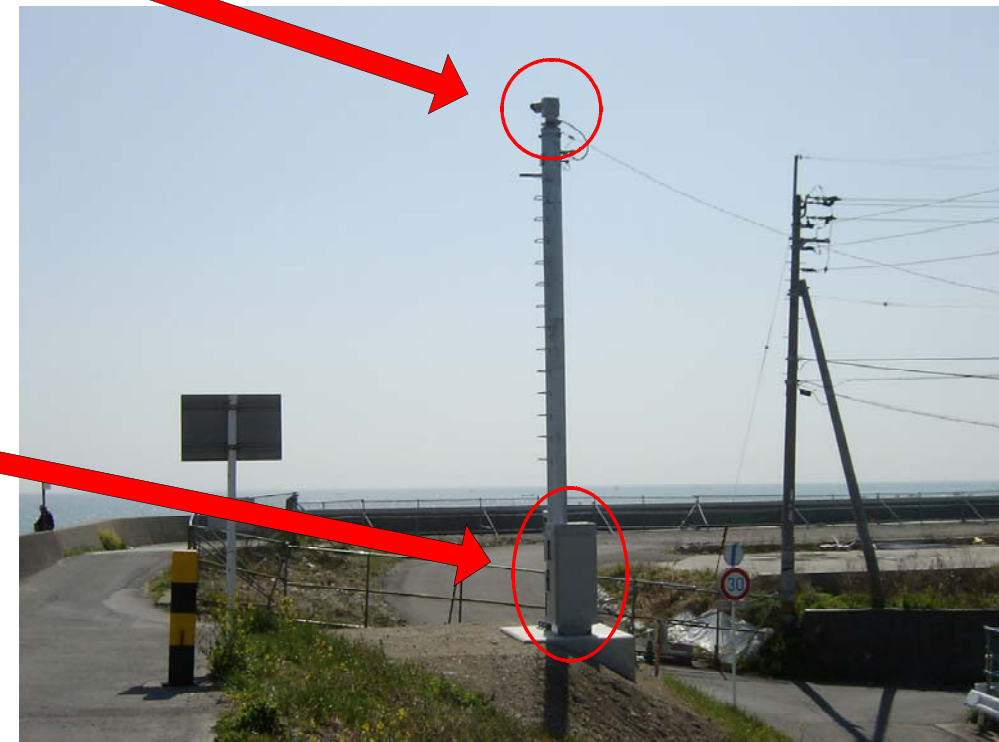
吉野川右岸河口に設置されたCCTV
