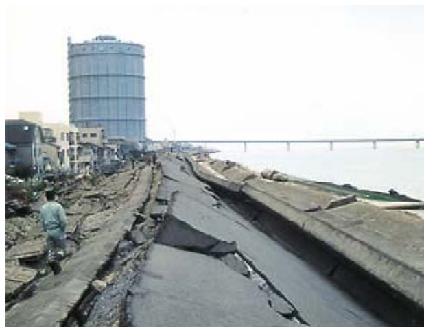
兵庫県南部地震による被災写真(淀川左岸1k0)
