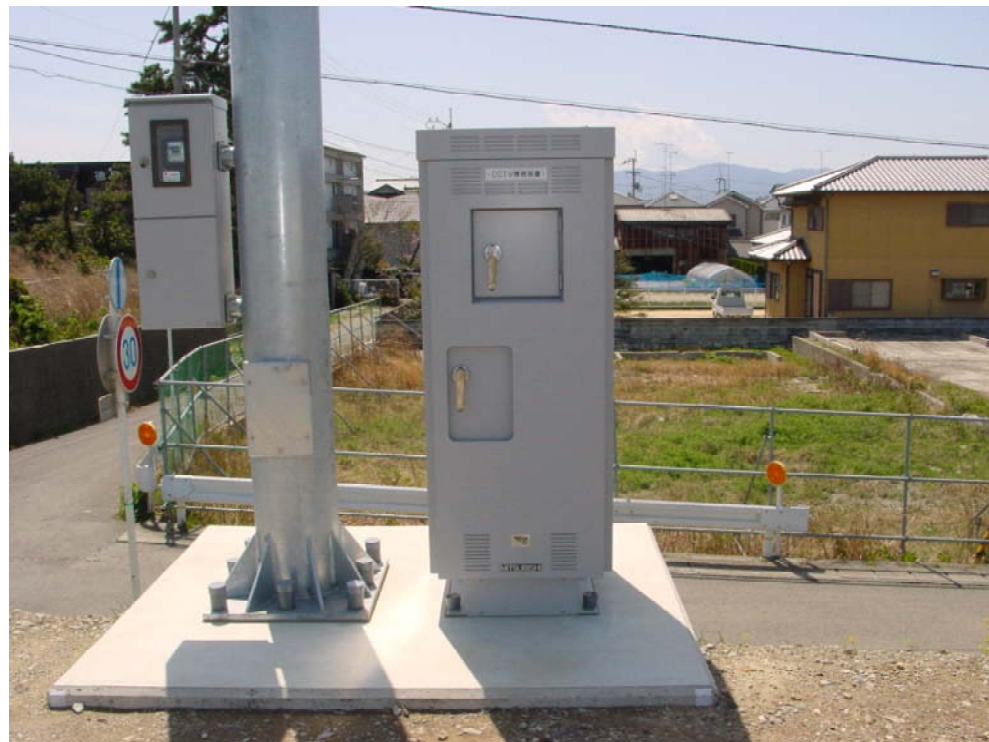
CCTV (附帯設備)
