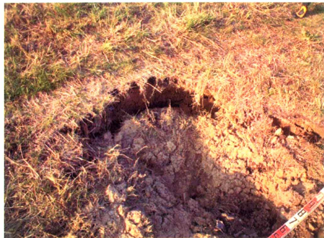
台風23号（堤体陥没） 川島町（R28k/4付近）
