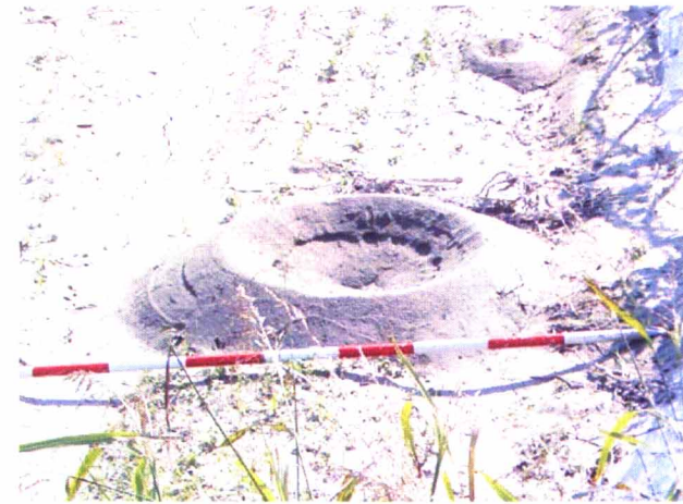
台風23号（漏水） 石井町（R15k/6付近）
