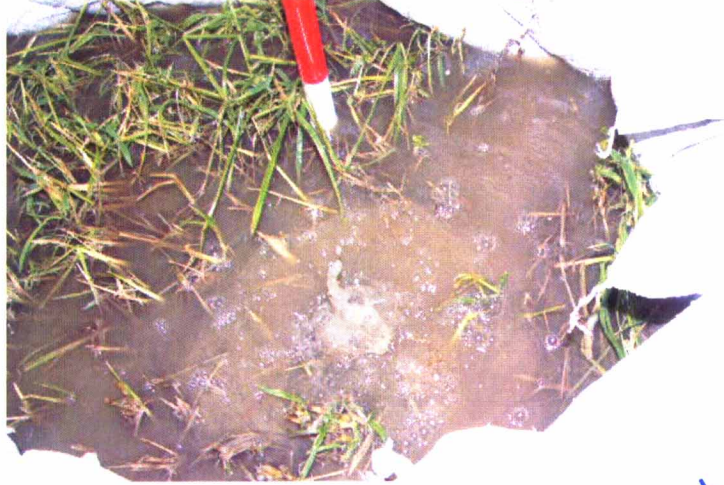
台風10号（漏水） 吉野町柿原（L23k/8付近）
