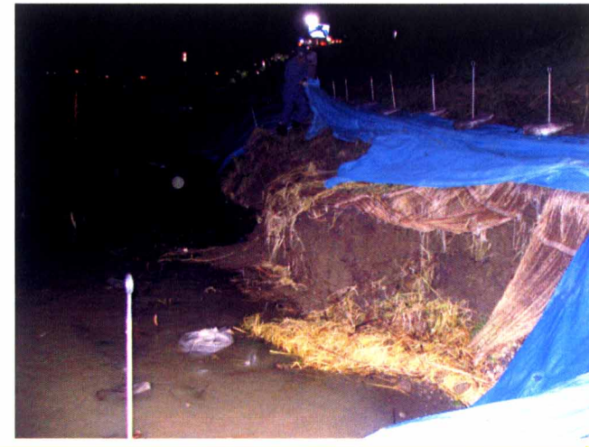
台風16号（堤防洗掘） 徳島市川内町（L4k/2付近）
