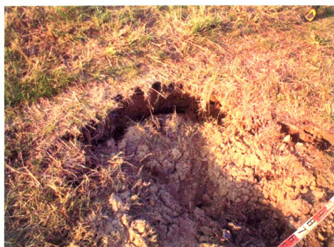
台風23号（堤体陥没） 川島町（R28k/4付近）
