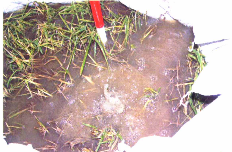
台風10号（漏水） 吉野町柿原（L23k/8付近）
