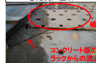
損壊による流水の 想定流入箇所
