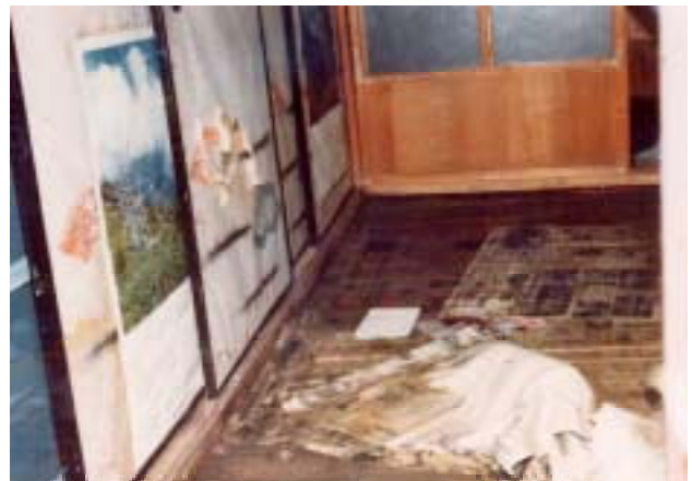
床上浸水した家屋の内部状況 (昭和51年洪水 江川流域)
