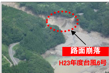
国道493号被災状況
