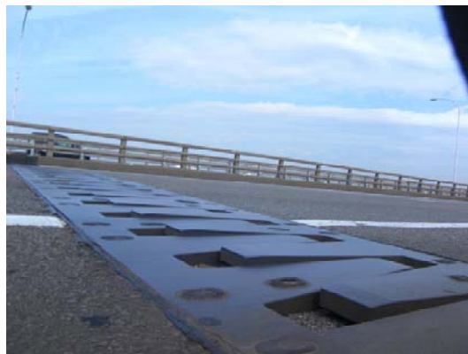
伸縮装置の浮き
