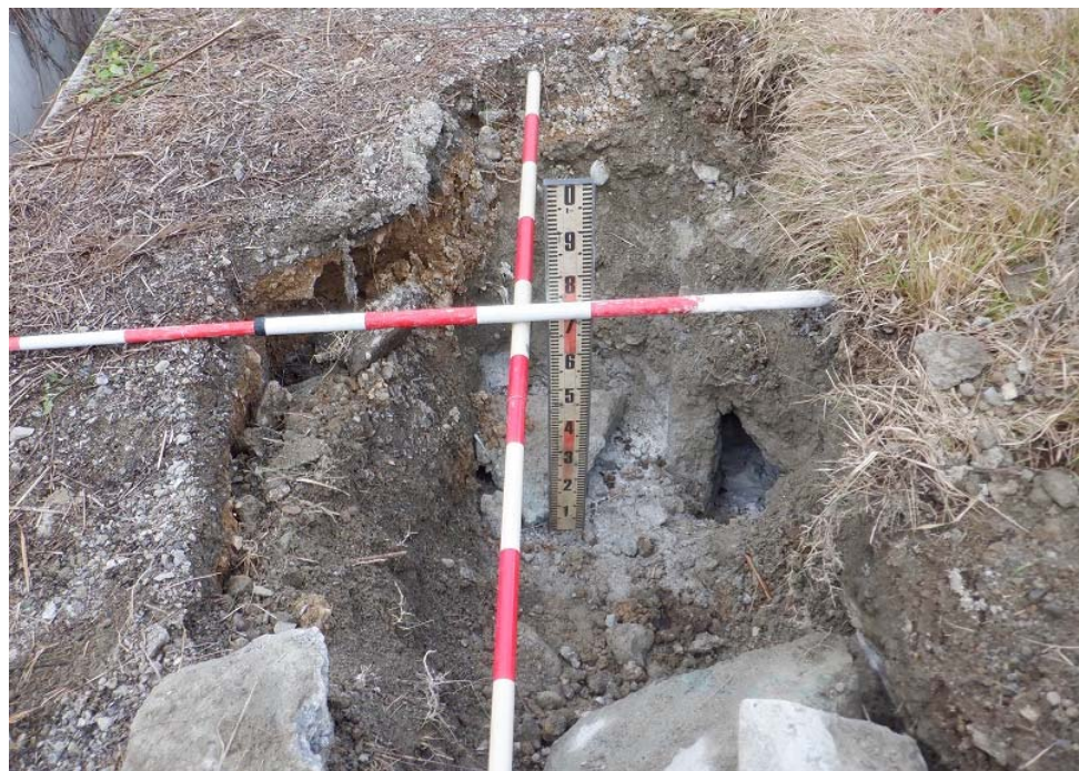
陥没（縦1.8m程度、横1.0m程度、深さ0.7m程度）
