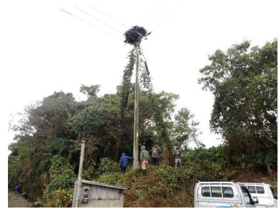
電柱巣塔の管理
